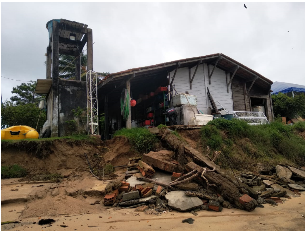
Figura 5: Detalhe da erosão (lado do galpão dos veículos).
