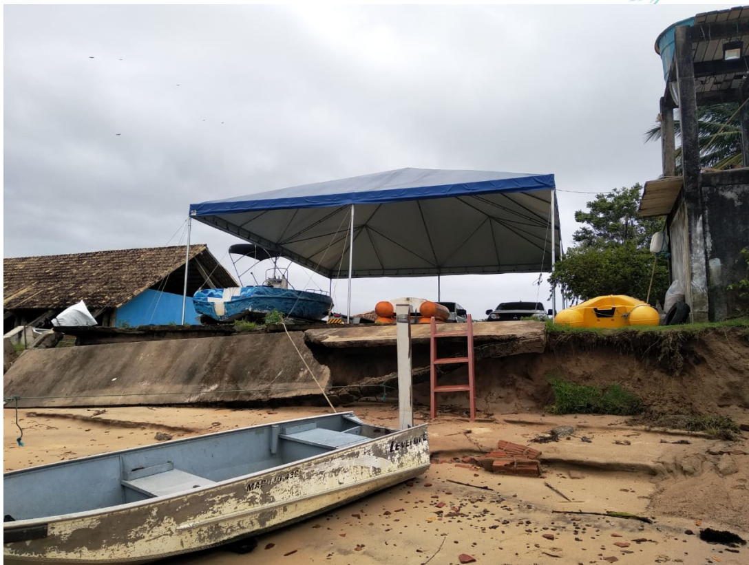
Figura 3: Detalhe da erosão (lado do galpão dos veículos). Foto tirada de costas para o Rio Caravelas.
