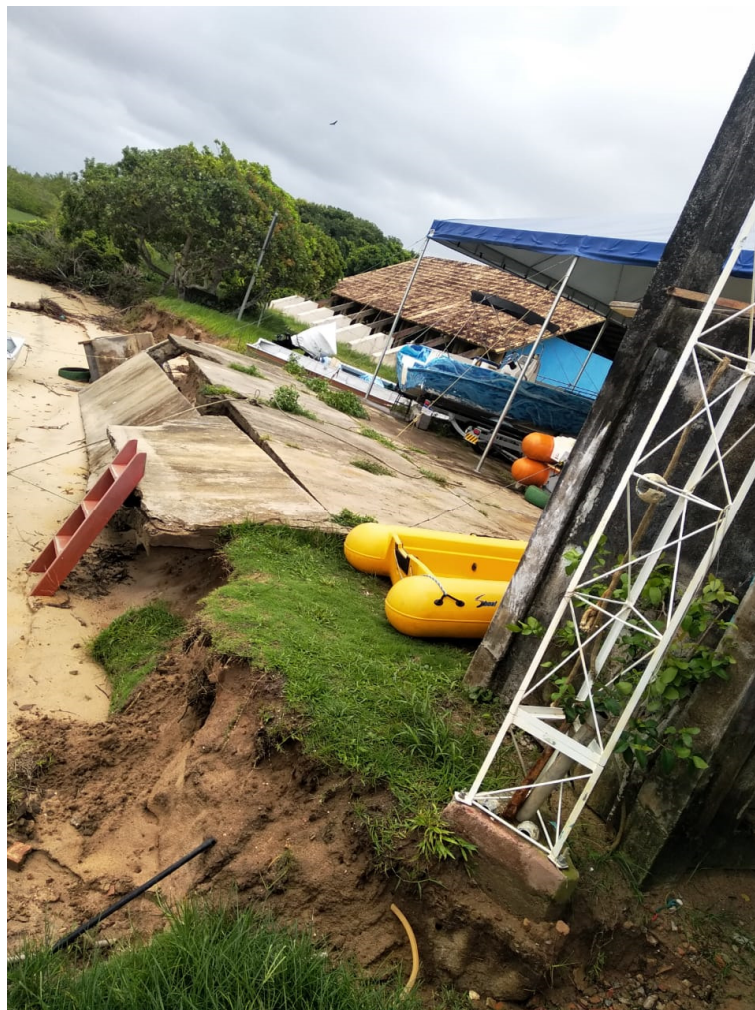
Figura 2: Detalhe da erosão (lado do galpão dos veículos).
